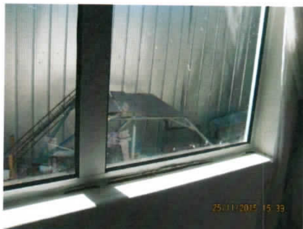
Fotografía N° 5: Ventana sin despiche
