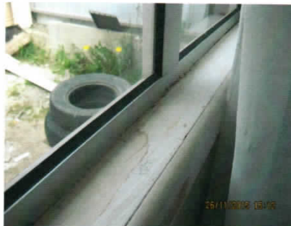
Fotografía N° 6: Ventana sin despiche
