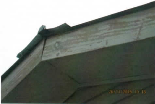
Fotografía N° 9: Tapacán sin la adecuada protección con barniz.
