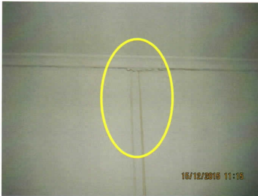
Foto N° 8: Filtración de agua hacia el interior de la ampliación.
