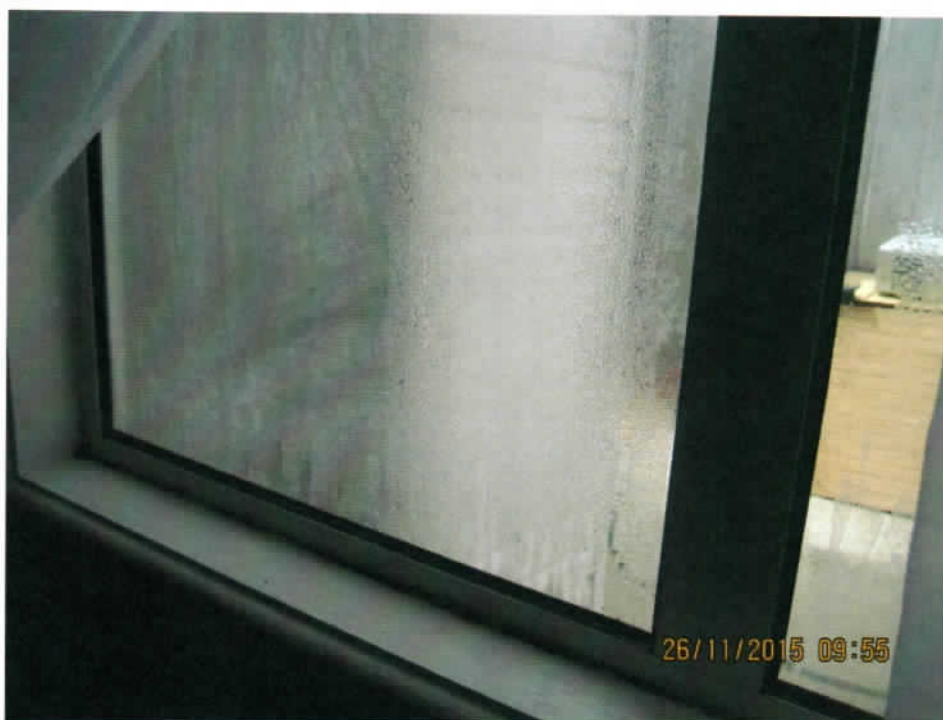
Fotografía N° 7: Falta ejecutar despiche para eliminar condensación
