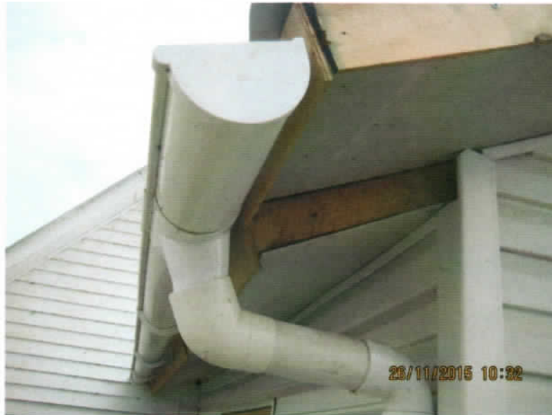
Fotografía N° 11: Tapacán sin la debida protección superficial.
